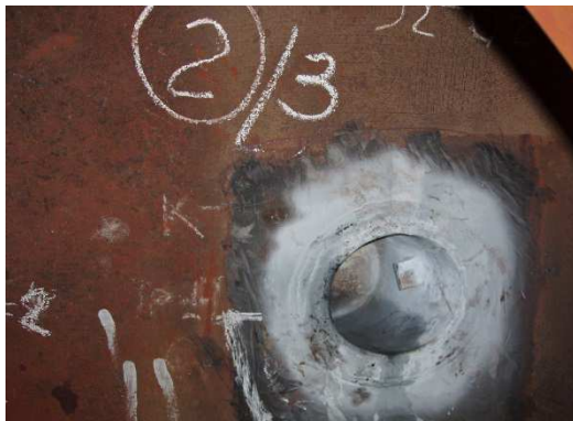
Рис. 1 Анкерная связь (анкер) № 2 котла ст. № 3
