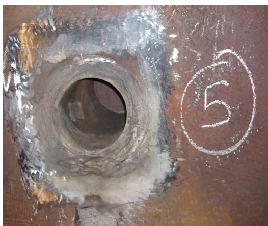
Рис. 2. Анкерная связь (анкер) № 5 котла ст. № 3
