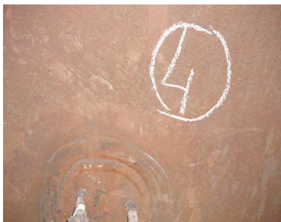
Рис. 3. Анкерная связь (анкер) № 4 котла ст. № 3
